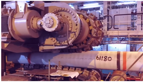
De pijpleiding voorbij de hydraulische regelaar
